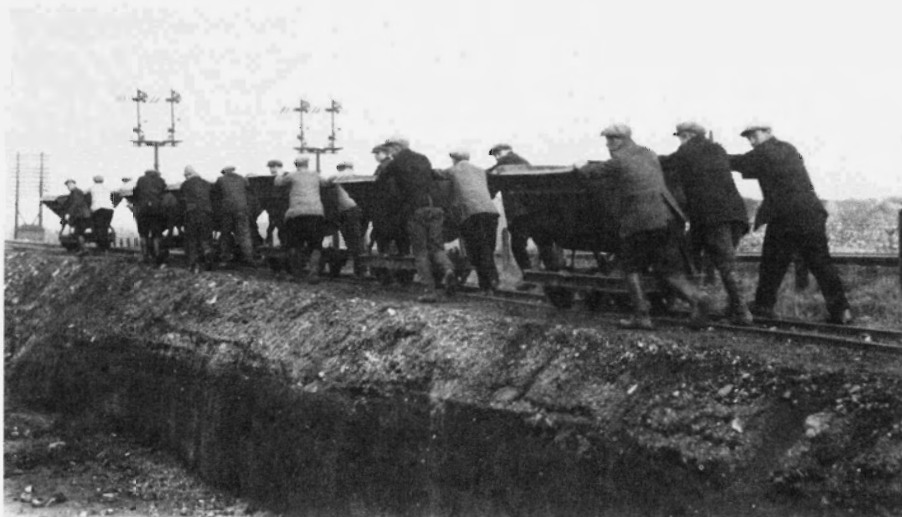
Om 'ledigheid' tegen te gaan, werden werkloze arbeiders ingeschakeld bij tal van openbare werken. Hier is een aantal van hen aan het werk bij de aanleg van de Viaductweg in Maastricht, 1931. Fotocollectie RHCL.
